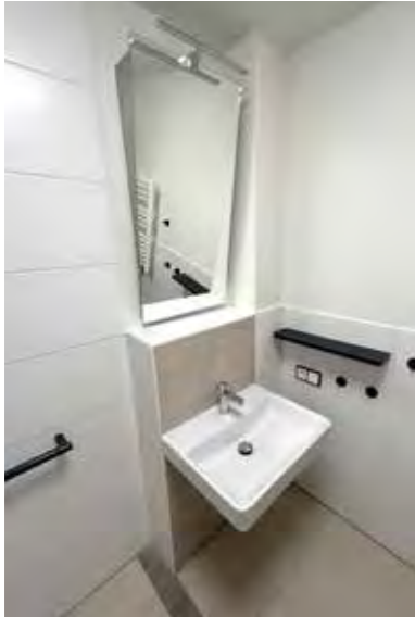
Bild 01 Schrägspiegel mit Leuchte über Vorwandinstallation
